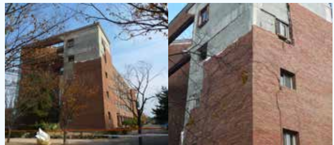
내진 철물 미사용 및 시방 미준수 시 벽체 탈락
