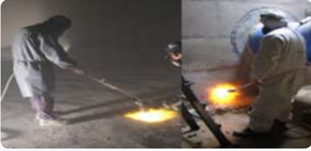
젖은 바탕, 습윤면 시공 불가능 (함수율 8% 미만 시공 가능, 건조작업 필수)
