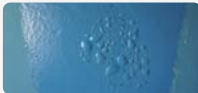
배수지 세라믹 메탈계 방수 하자보수 후 재하자 발생 상태
