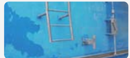
E 정수장 침전지 코팅제 하자보수 후 재하자 발생 상태
