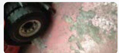
물류창고 에폭시 라이닝 마감상태
