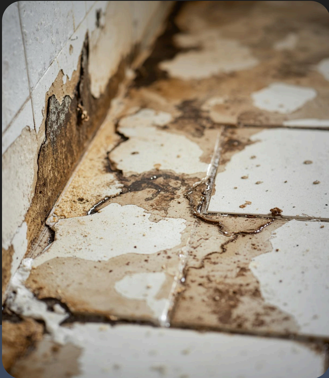
누수로 인한 구조·마감재 손상 확대
