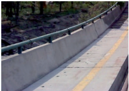
자동차 전용도로 가드레일 콘크리트 균열/보수 및 중성화방지
