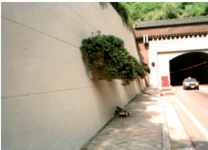
콘크리트 옹벽 크랙(균열)/보수 중성화방지
