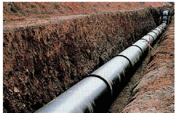
지하 가스, 수도 배관
