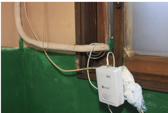
에어컨 배관과 통신선이 유리창을 관통하여 기밀성능이 저하
